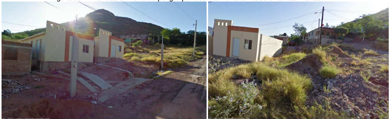
Figura 56. Viviendas en zona de peligro por deslizamiento en la colonia Las Plazas II
